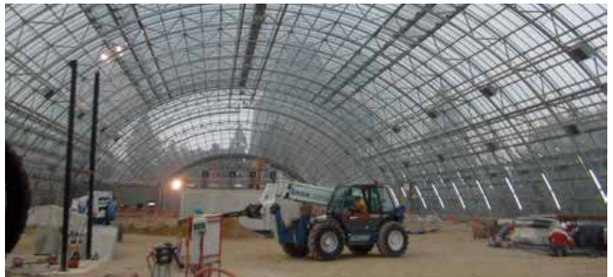
Construction de la grande serre du zoo de Vincennes par l'entreprise Marcheguy.
